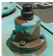
汚れたエアブリーザー
