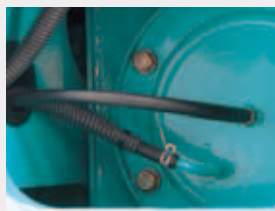
清掃用の底面フランジ付き燃料タ ンク
