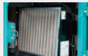
左後方ガード：iNDrフィルタ/バ ッテリー/冷却機器/ラジエータ冷却水/ 他
