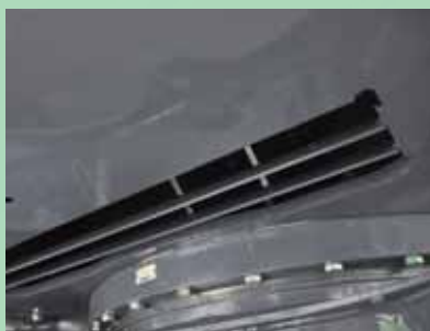
ルーバータイプの排風口
