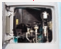
右サイド 油圧ポンプ/ 燃料フィルタ/ ウォータセパレータ
