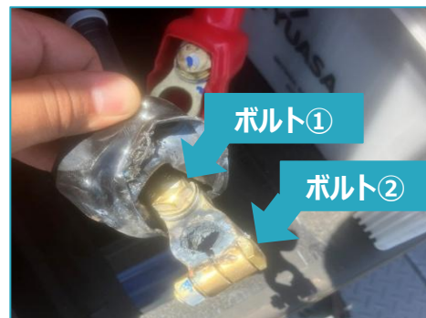
【バッテリーターミナル】
