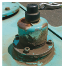
汚れたエアブリーザー
