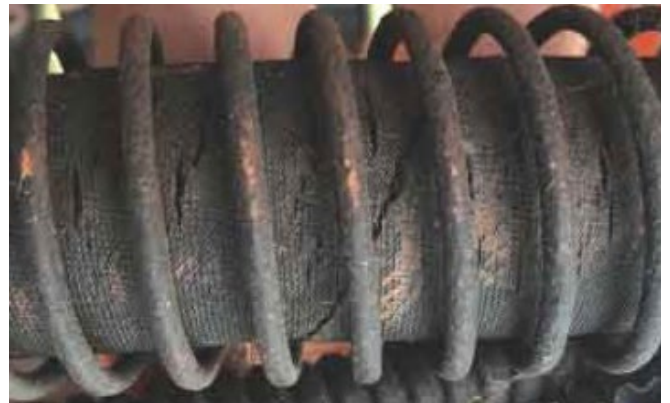
劣化してひび割れたホース
