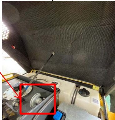
図：エンジンボンネット内の写真
