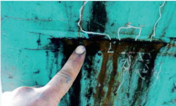
✓ 錆び水のチェック
